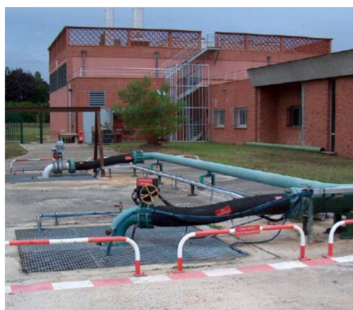
Figure 105 – Têtes de puits en surface
